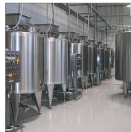
Pesaje de tanques
